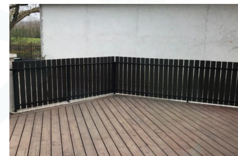
Barrière de terrasse sécurisée
