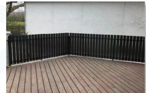
Barrière de terrasse sécurisée
