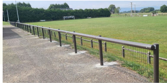
Barrière main-courante + sécurisation avec panneau grillagé
